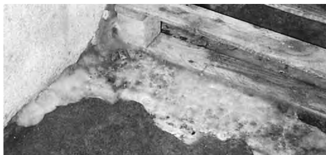
Här har mycel spridit ut sig på källargolvet i en fastighet (ej Flottbo). Foto: Sirpa Ahonen, BBAB
