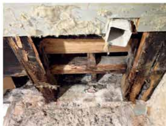
Innertak och bjälklag var som syns i stort behov av renovering
